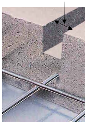
Joint de fractionnement
