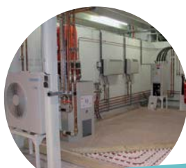
Plate-forme pompes à chaleur
