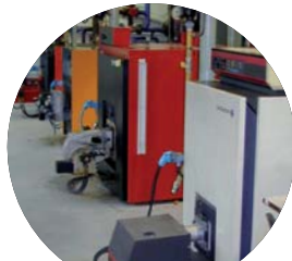
Plate-forme chaudières et brûleurs
