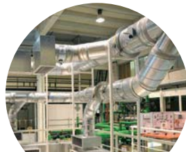
Plate-forme réseau aéraulique
