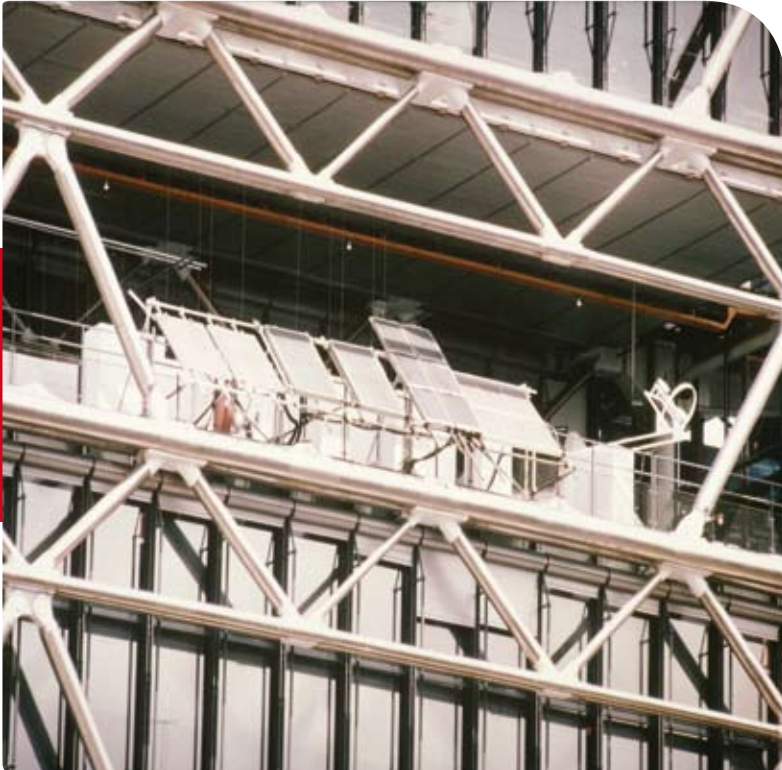
Essais de capteurs solaires au Centre Georges Pompidou en 1977 pour la production d'eau chaude sanitaire
